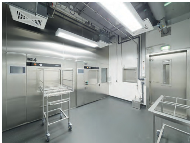
Bild 8. Barriere des S3-Bereichs: links zwei Durchreicheautoklaven zum Ausschleusen von Material und Abfällen, rechts der Durchgang zur Personalschleuse (Fotos 7 und 8: Thomas Ott, www.o2t.de)
