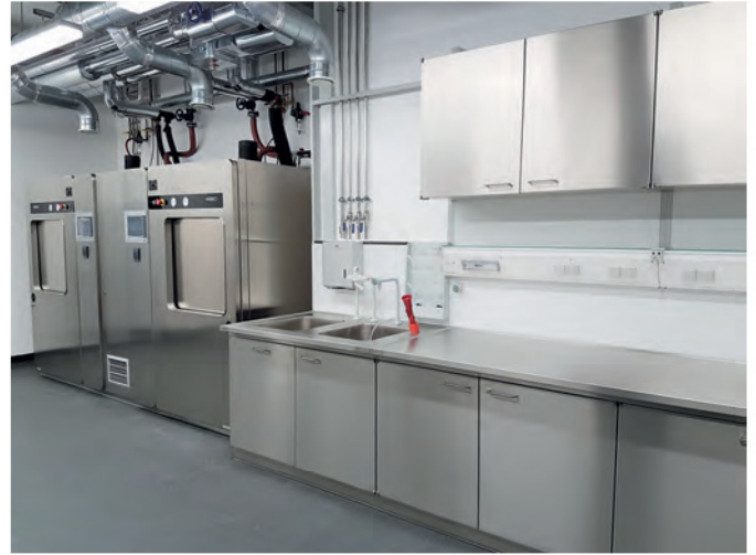
Bild 5. Spülküche im S2-Bereich: Spültischanlage mit redundant ausgelegten Autoklaven
