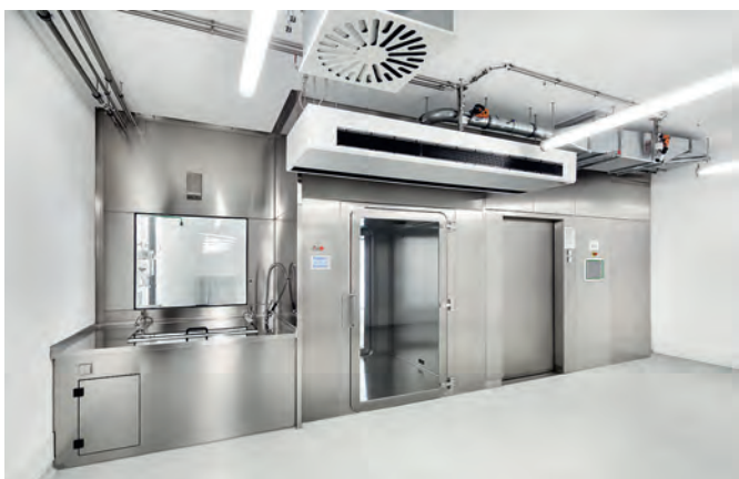
Bild 4. Niedersächsisches Zentrum für Biomedizintechnik, Implantatforschung und Entwicklung (NIFE), Hannover: Barriere in der Tierhaltung, bestehend aus Großraumautoklav, Wasserstoffperoxid- und Tauchschleuse
