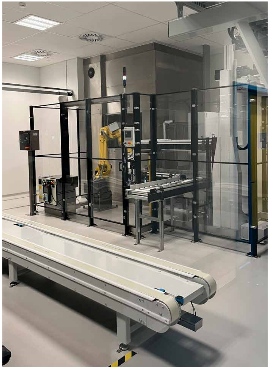
Ein Frei-Arm-Roboter entlastet die AEMP-Mitarbeitenden beim Be- und Entladen der Transportwägen.
